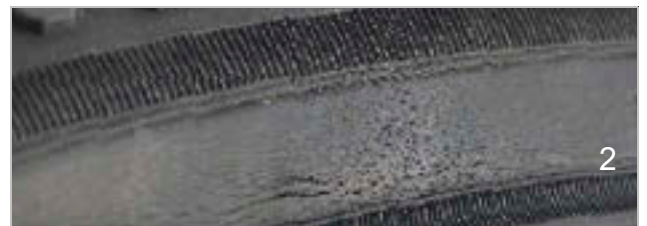
Illustration 177 : Exemples de fissures de fatigue (1) et de fissures d'âge (2)
