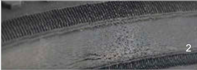
Figur 200: Eksempler på materialetræthedsskader (1) og ældningsrevner (2)
