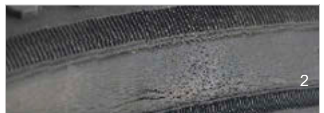
200. ábra: Példák kifáradási repedésekre (1) és öregedési repedésekre (2)
