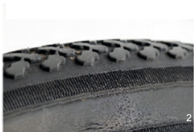
Figura 103: Ejemplos de fisuras por fatiga (1) y fisuras por envejecimiento (2)
